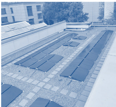
Neue PV-Anlage auf dem Garderoben- und Tribünendach der Schulanlage Eseleriet
