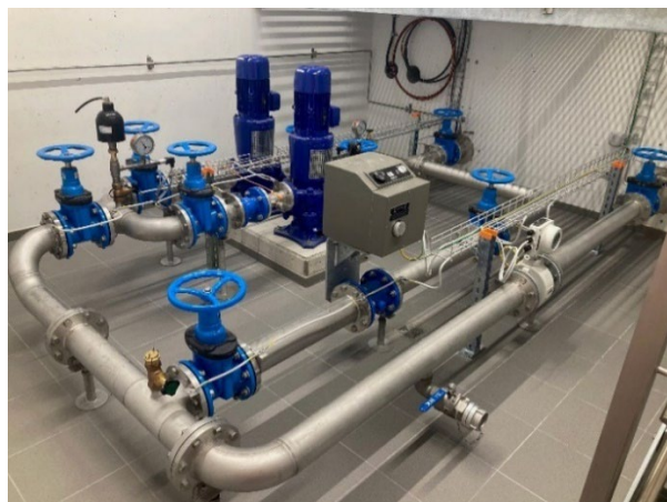
Rohrkeller Stufenpumpwerk Luckhausen
