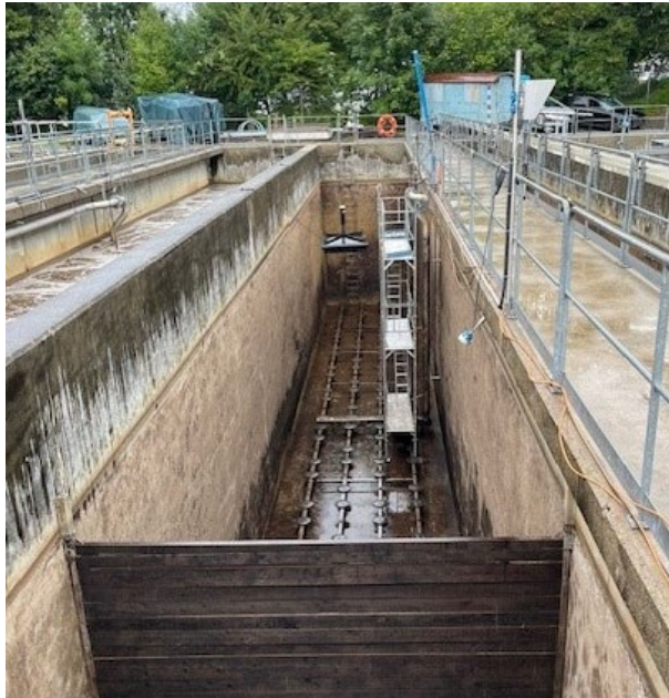
Belebtschlamm Becken (Zone 1) mit Belüftungsmembranen
