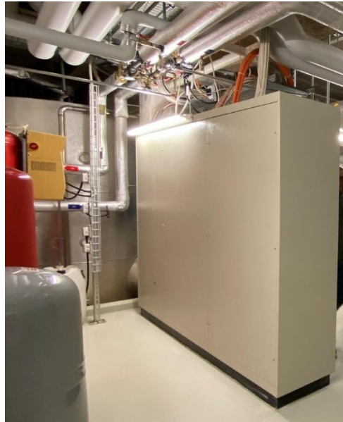
Abbildung 29: Bestehende Elektroverteilung in der Energiezentrale
