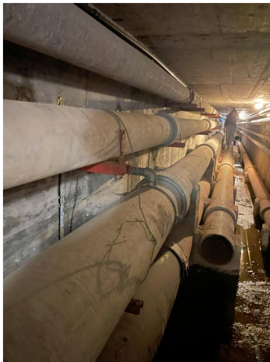
Abbildung 30: Bestehende Leitungen im Medientunnel
