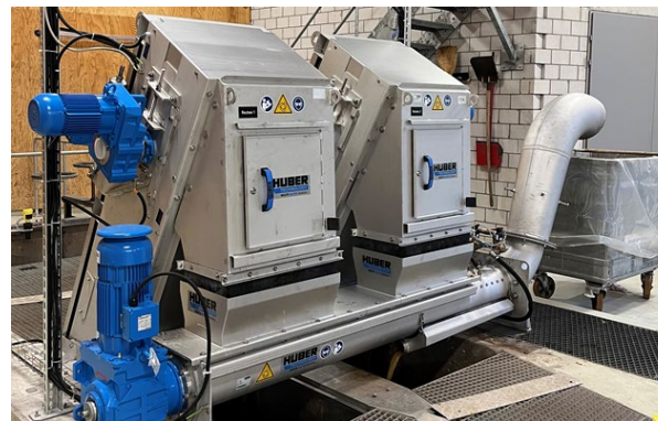
Neue Rechenanlage im Zulaufbereich
